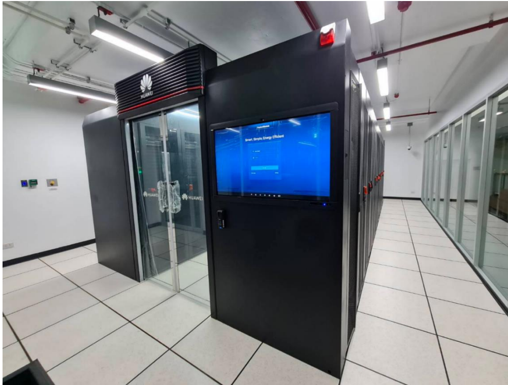
ห้อง Data Center
